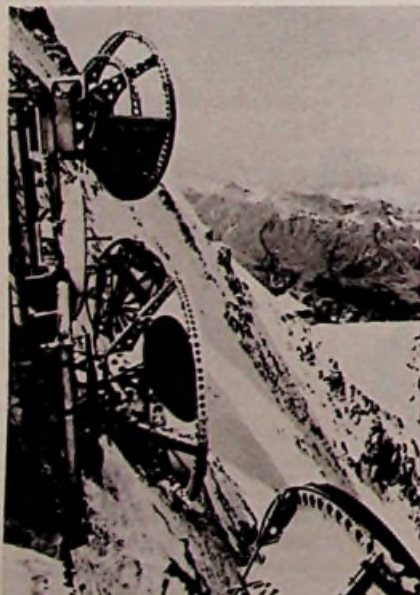
Afb. 2. Deel van de antenne installatie van het relaisstation op de Ostgrat van de Jungfrau-top, waarmee sedert 1954 de Alpen worden overbrugd.
